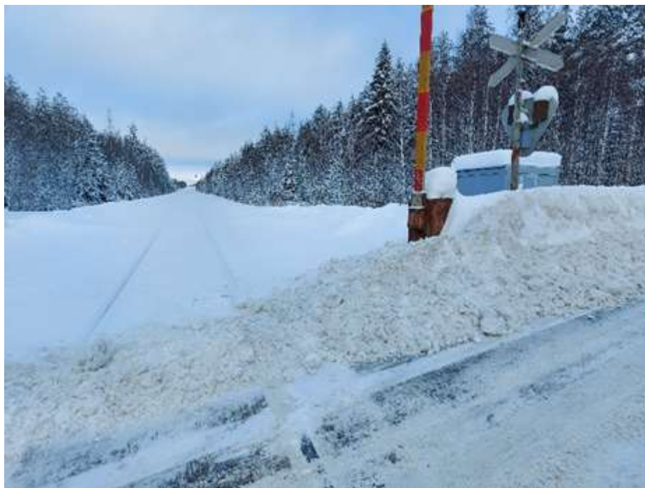
Kuva: Väylävirasto Ei näin! Tällaista lumivallia ei saa jäädä näkemäesteeksi. Myös tien ja tasoristeuksen yhtymäkohdassa on haitallinen polanne.
