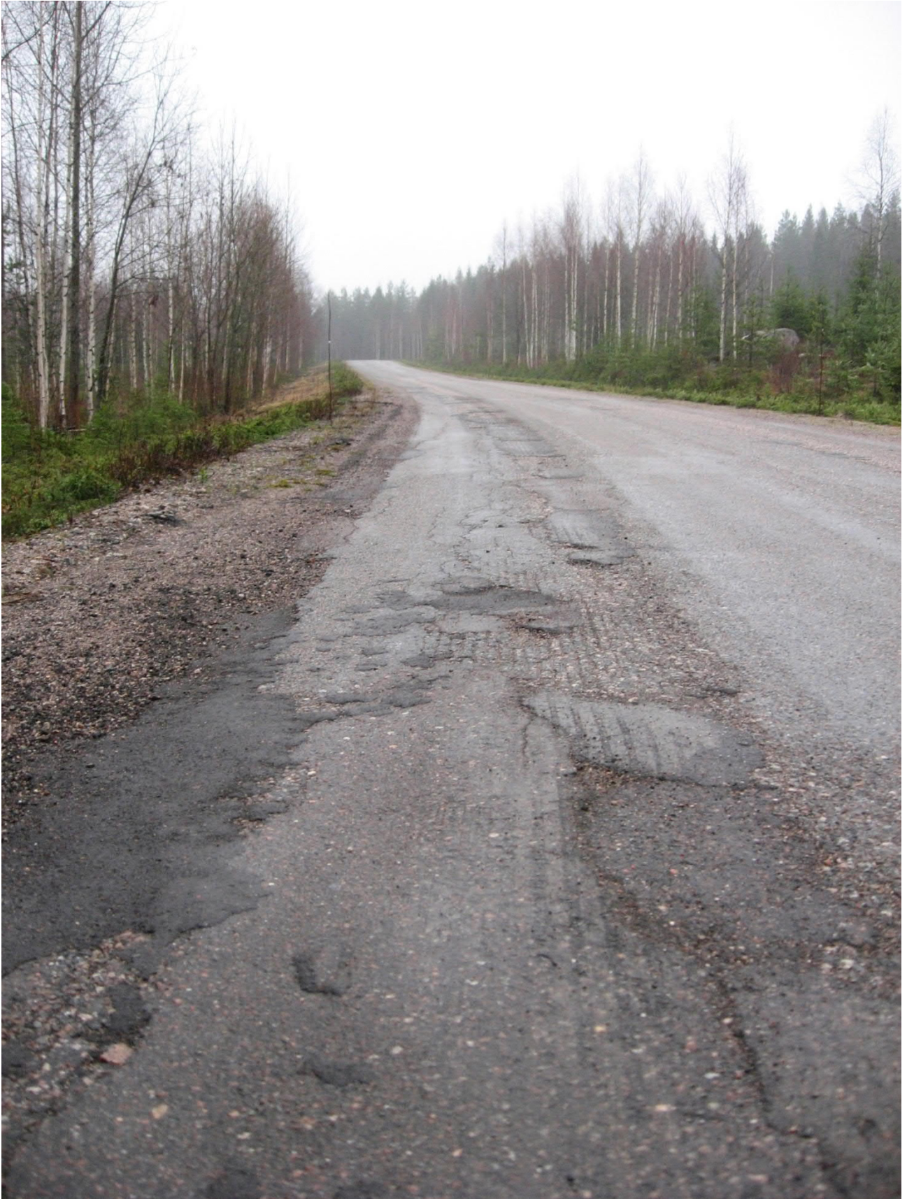
Kuva 1. Päällysteen paikkauksen haasteita.
