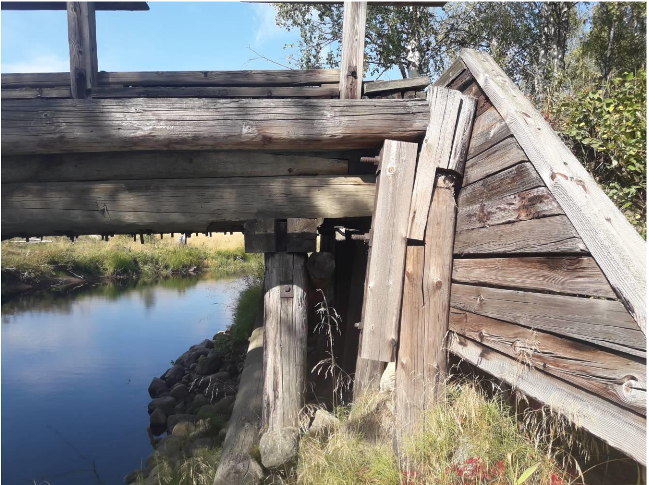
Kuva 12. Sillan maatuki 1 vauriot
