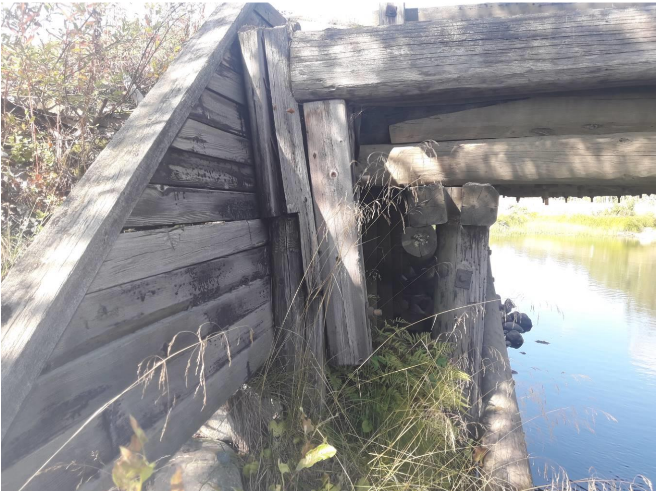
Kuva 13. Sillan maatuki 2 vauriot
