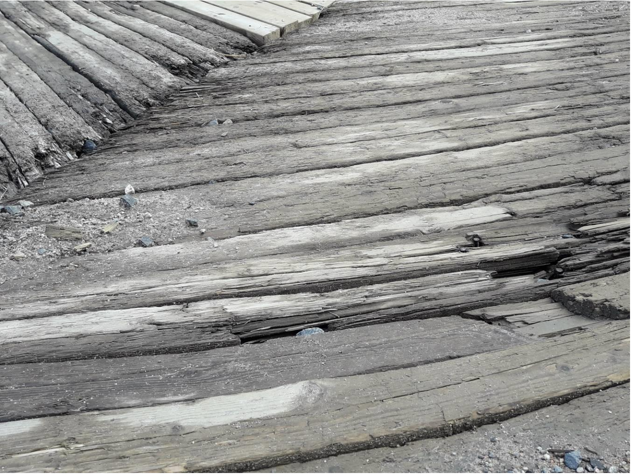
Kuva 14. Sillan kannen vauriot
