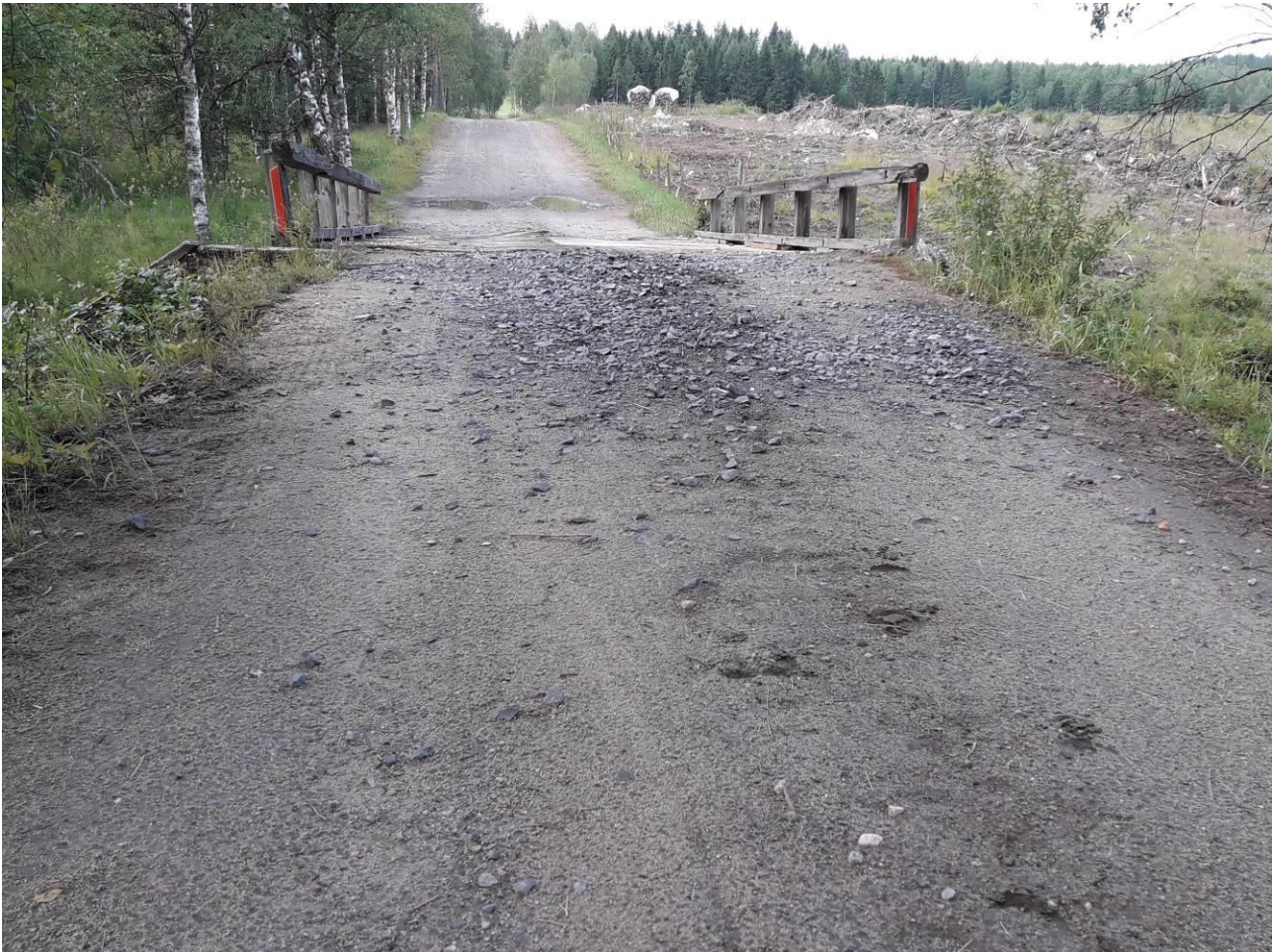
Kuva 11. Sillan muodonmuutos näkyy kohoamisena tiellä
