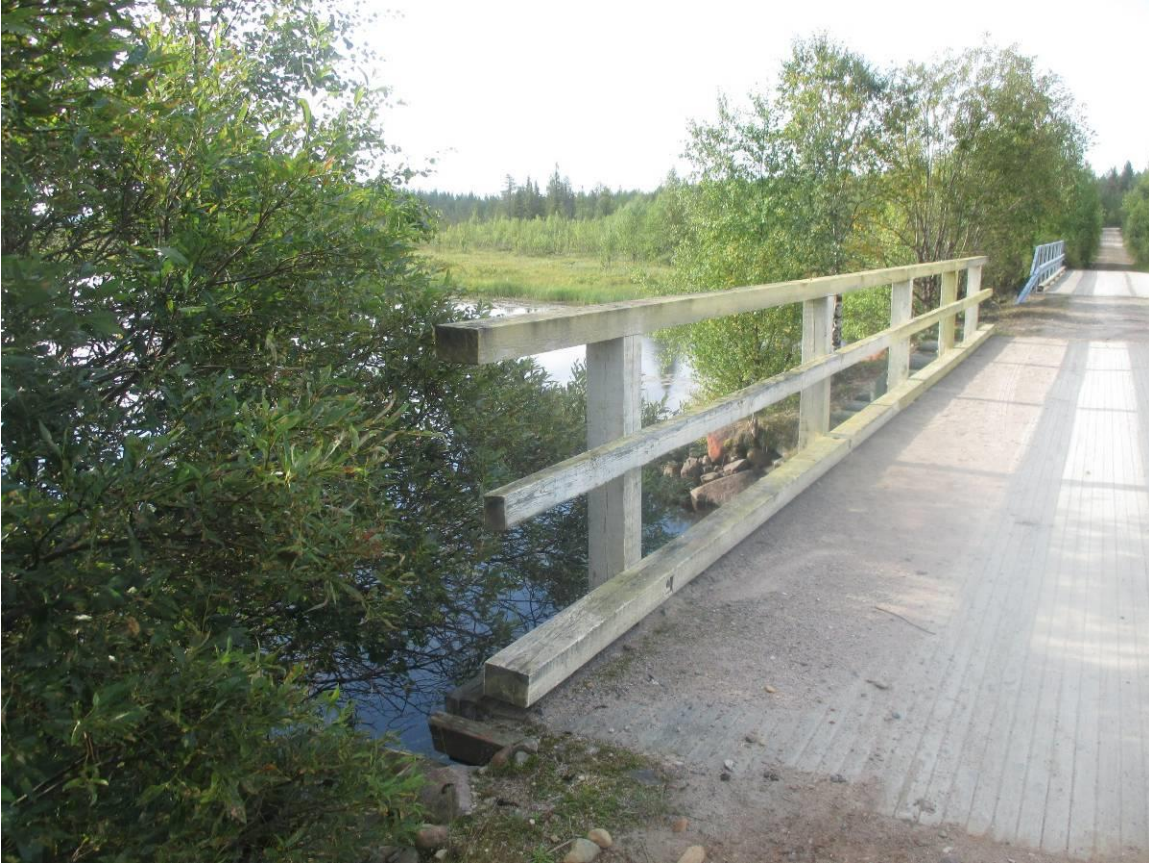
Kuva 10. Sillan kaiteet, pengerkaiteet puuttuvat.
