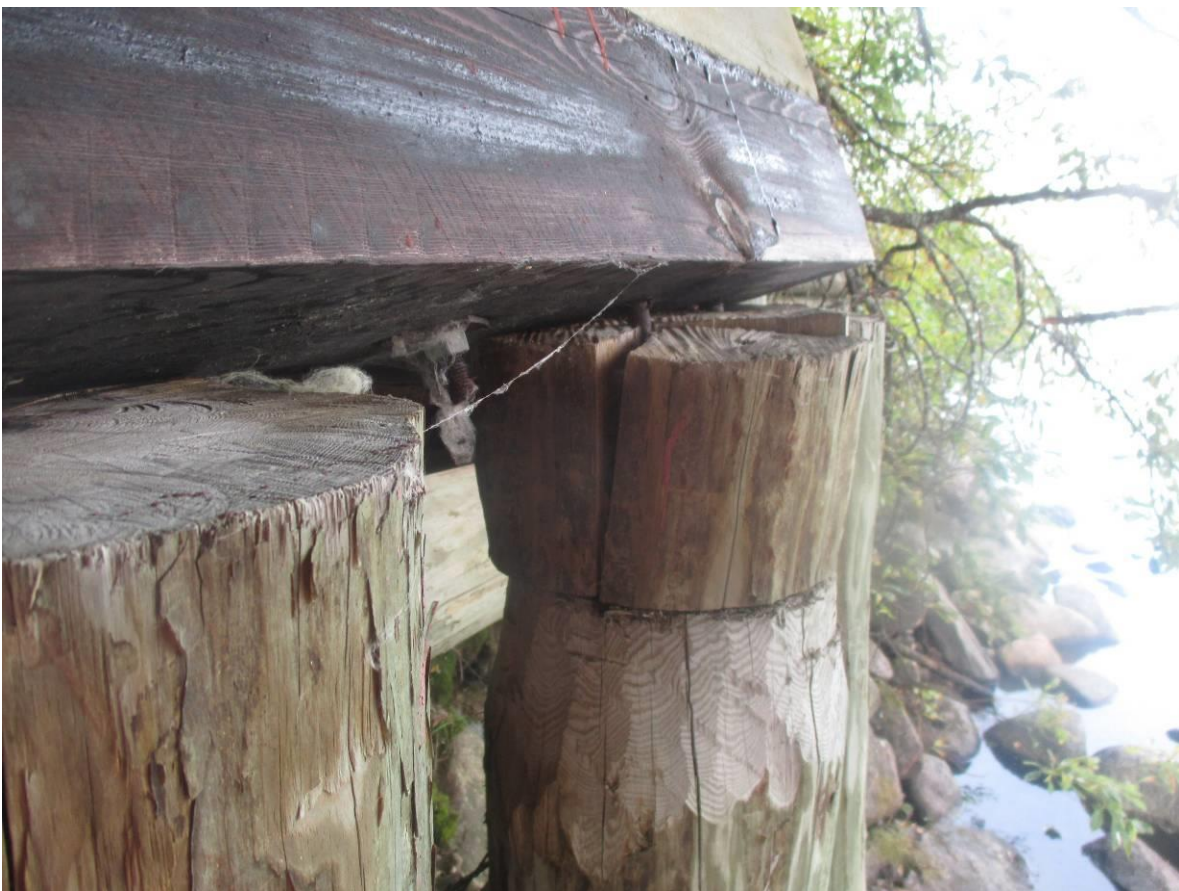
Kuva 29. Maatuki 2. , paalun rakennusvirhe ja halkeamisvaurio.
