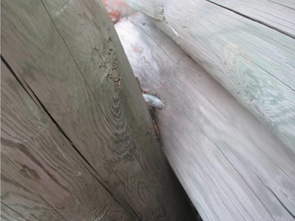
Kuva 14. Maatuki 1. , vauriot, perustuspaalun kiinnitys tukipuuun.
