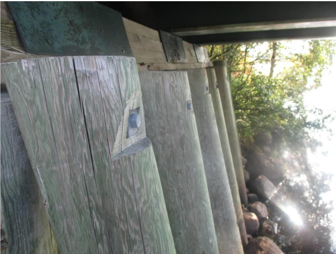
Kuva 15. Maatuki 1. , vauriot, pulttien kiinnityspaikka liian ylhäällä ja materiaalin vahvuus ei riittävä.
