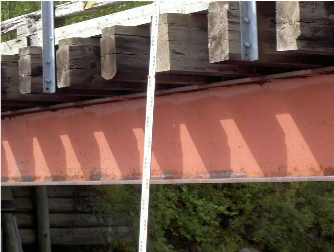
Kuva 34. Sillan kaidepylväiden puutteellinen kiinnitys.
