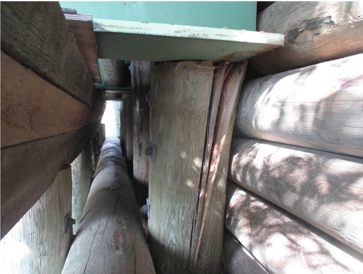
Kuva 13. Maatuki 1. , vauriot, tukipuun halkeama.
