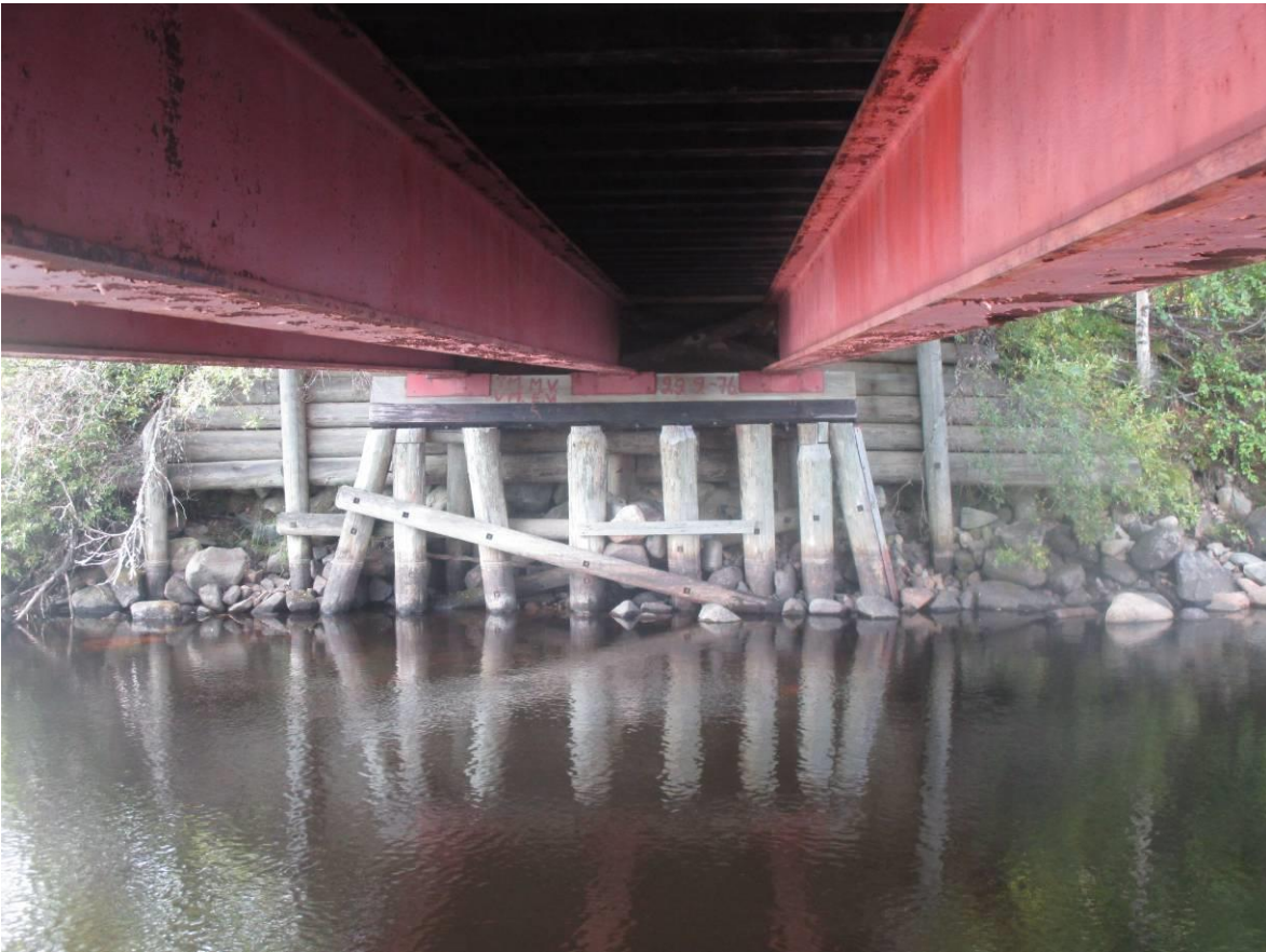
Kuva 32. Sillan teräspalkkien korroosiovauriot.
