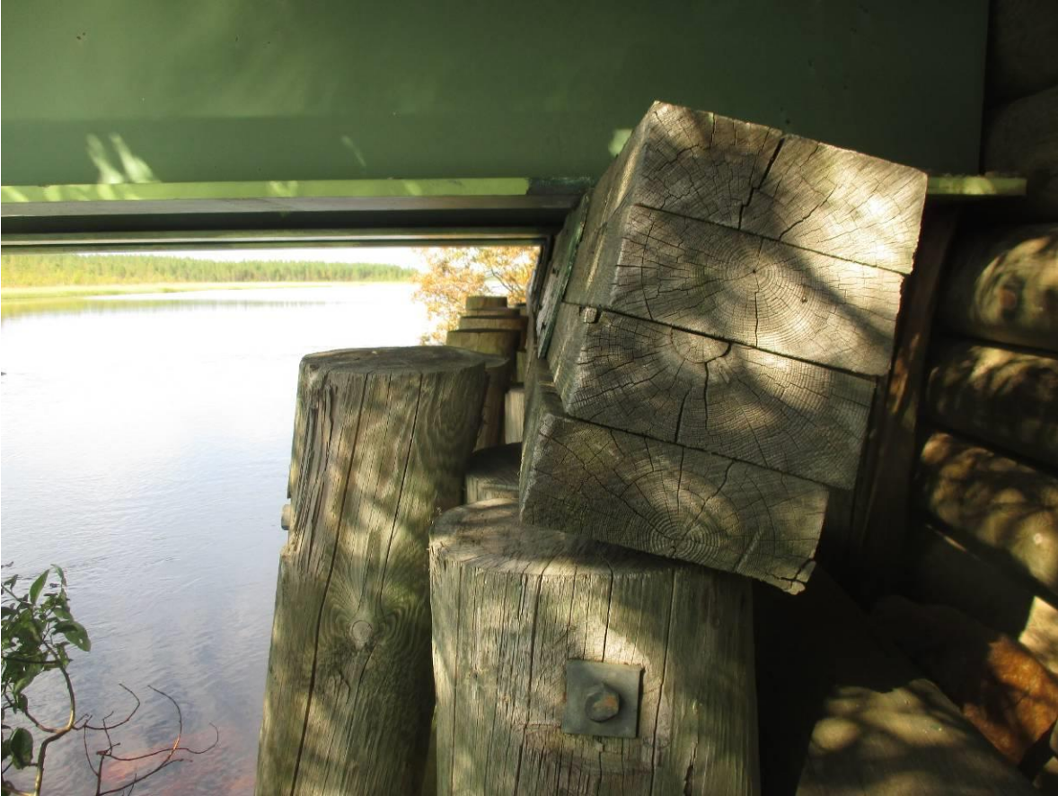
Kuva 12. Maatuki 1. , vauriot, laakeritason kallistuminen.
