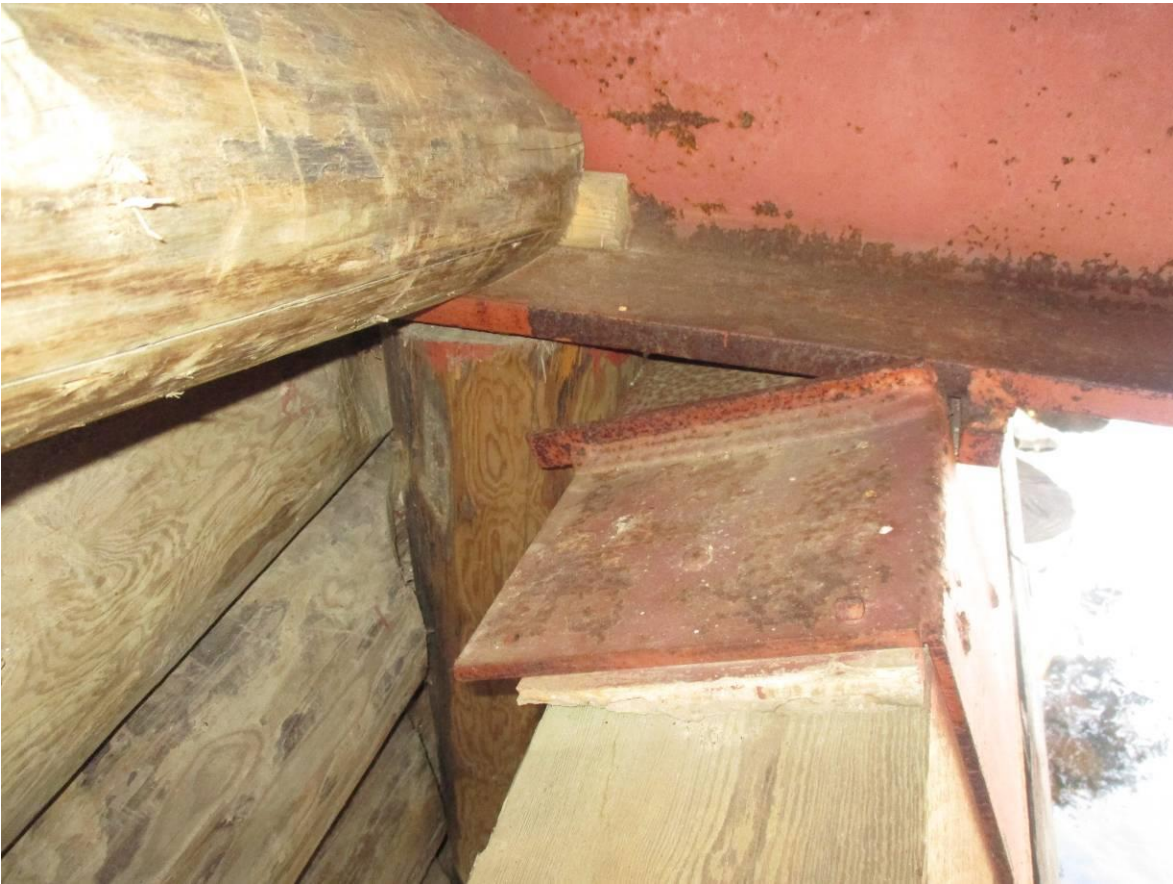
Kuva 30. Maatuki 2. , kiinnityksen irtoamisvaurio.
