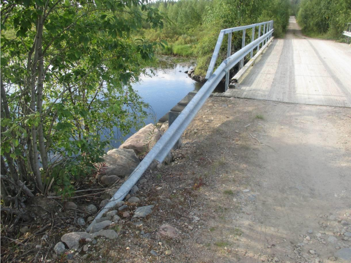
Kuva 26. Sillan kaiteet, pengerkaiteet puuttuvat.
