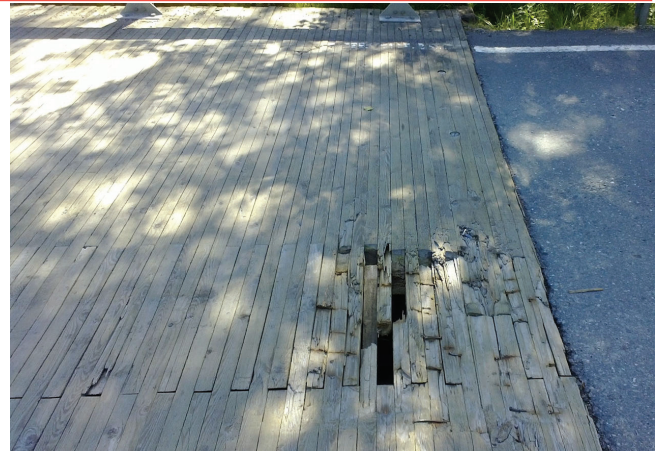
Kuva 15. Syrjälankkukannen harjan kohdalla ei ole pääkannattajaa, mikä on johtanut syrjälankkukannen vaurioitumiseen päällysraakenteen päädyssä
