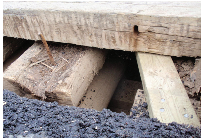
Kuva 12. Puisen pääkannattajan lahovaurio syrjä-lankkukannen alla
