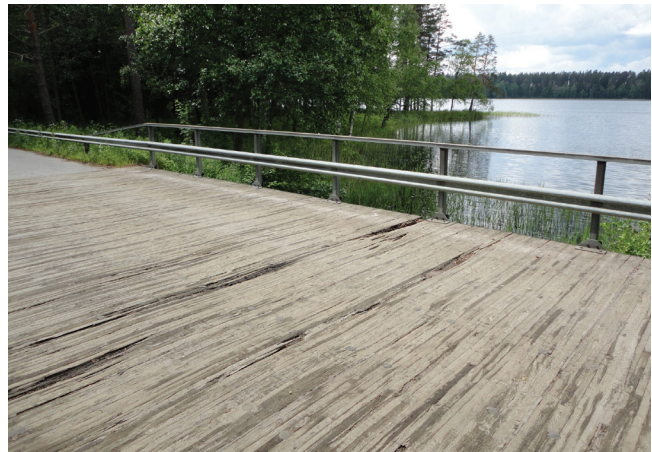
Kuva 13. Kulunut ja osin lahonnut syrjälankkukansi.
