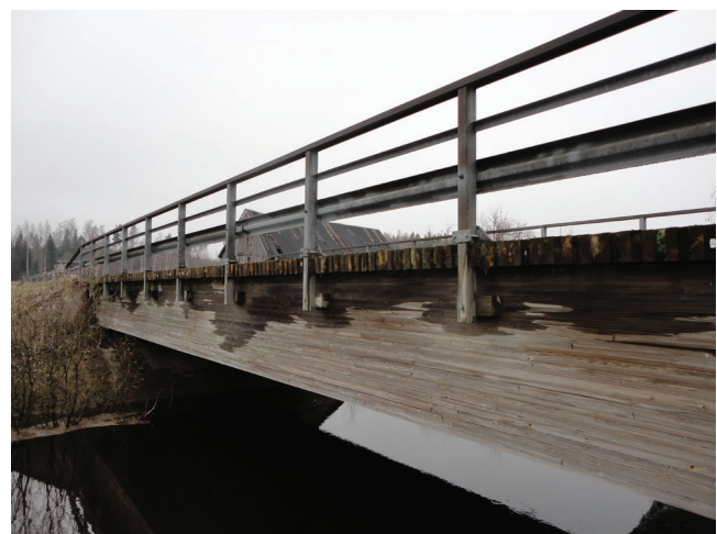
Kuva 14. Päällystämättömän syrjälankkukannen rakoilu aiheuttaa vesivuotoa, mikä johtaa pääkannattajien kostumiseen
