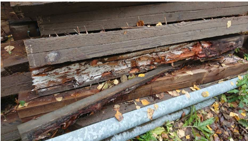
Kuva 1. Sulansalmen sillan purettua kansilankutusta. Lankutuksen yläpinta on ehjän näköinen, vaikka sisältä lankutus on ollut aivan laho. (Kuva: Insinööritoimisto Suunnittelukide Oy)
