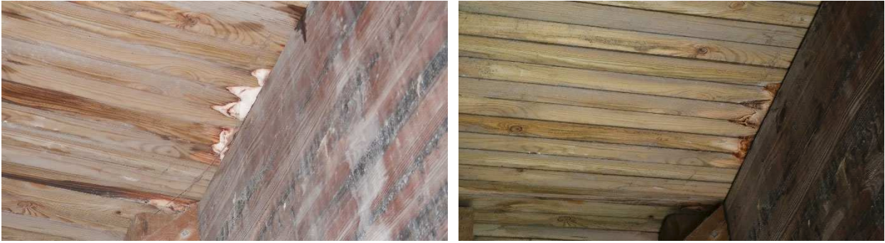
Kuva 2. Pitkäkosken sillan kannen alapinta samasta kohtaa eri ajankohtana. Oikean puoleisessa kuvassa sienikasvusto on kuivunut kuivan kauden aikaan. (Kuvat: Insinööritoimisto Suunnittelukide Oy)
