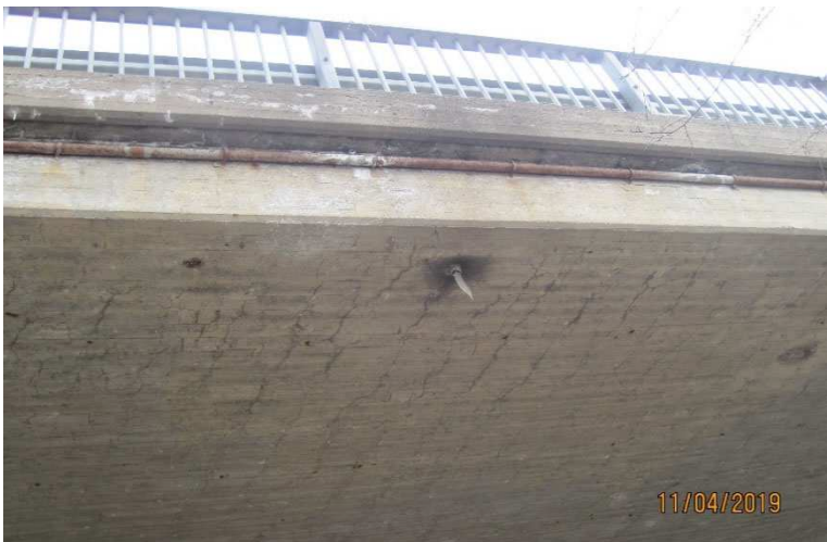
Kuva 8. Laatan alapinnan ruutumainen halkeilu kertoo todennäköisestä alkalikiviainesreaktiosta. AKR vauriokirjaus: Verkkohalkeilu VL2. Huom! Kuvan tapauksessa kirjataan myös vesivuotovaurio laatalle ja tippuputken ohivuoto. (Kuva: Ramboll Finland Oy)
