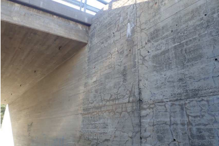
Kuva 5. Tyypillinen alusrakenteen AKR-vaurio. Kuivan ja kosteusrasitukselle alttiin pinnan raja erottuu selvästi. Halkeilu on ruutumaista ja märän näköistä. Halkeamissa on havaittavissa täytettä. AKR vauriokirjaus: Verkkohalkeilu VL2. (Kuva: Ramboll Finland Oy)
