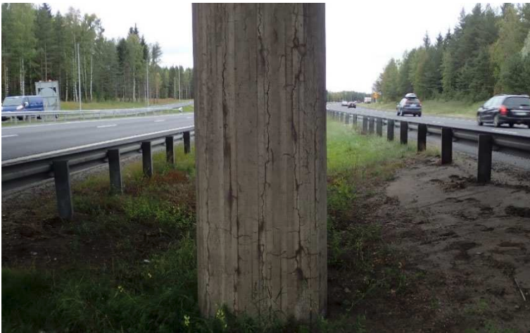
Kuva 7. Pilarit ovat alttiita roiskevedelle ja suolasumulle. Halkeamaleveys on kohtalaisen suuri ja vaikuttaa ulottuvan syvälle. Tiesuolan mukana tulevat alkalit saattavat voimistaa reaktiota halkeilleessa rakenteessa. AKR vauriokirjaus: Verkkohalkeilu VL2 (Jos vauriokohta rajoittuu selvästi roiskealueelle) tai VL3 (jos pilari on vaurioitunut laajalta alueelta). Huom! Suuremmat raudoituksen suuntaiset halkeamat ovat monesti teräskorroosion aiheuttamia. (Kuva: Ramboll Finland Oy)
