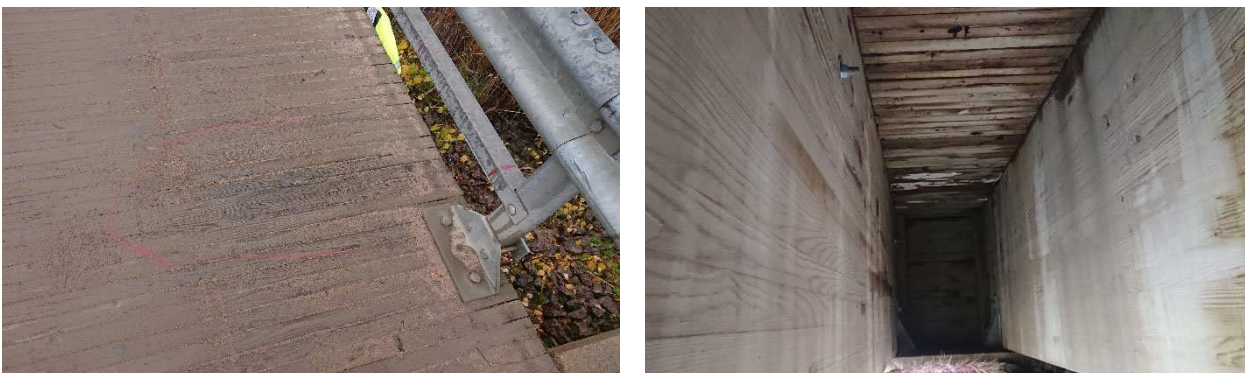
Kuva 4. Sydänsalmen sillan kansilankutus, kuvissa sama kohta kannen ylä- ja alapuolelta. Yläpuolelta havaitaan kannen yläpinnassa tummentuma vaurion kohdalla. (Kuva: Insinööritoimisto Suunnittelukide Oy)
